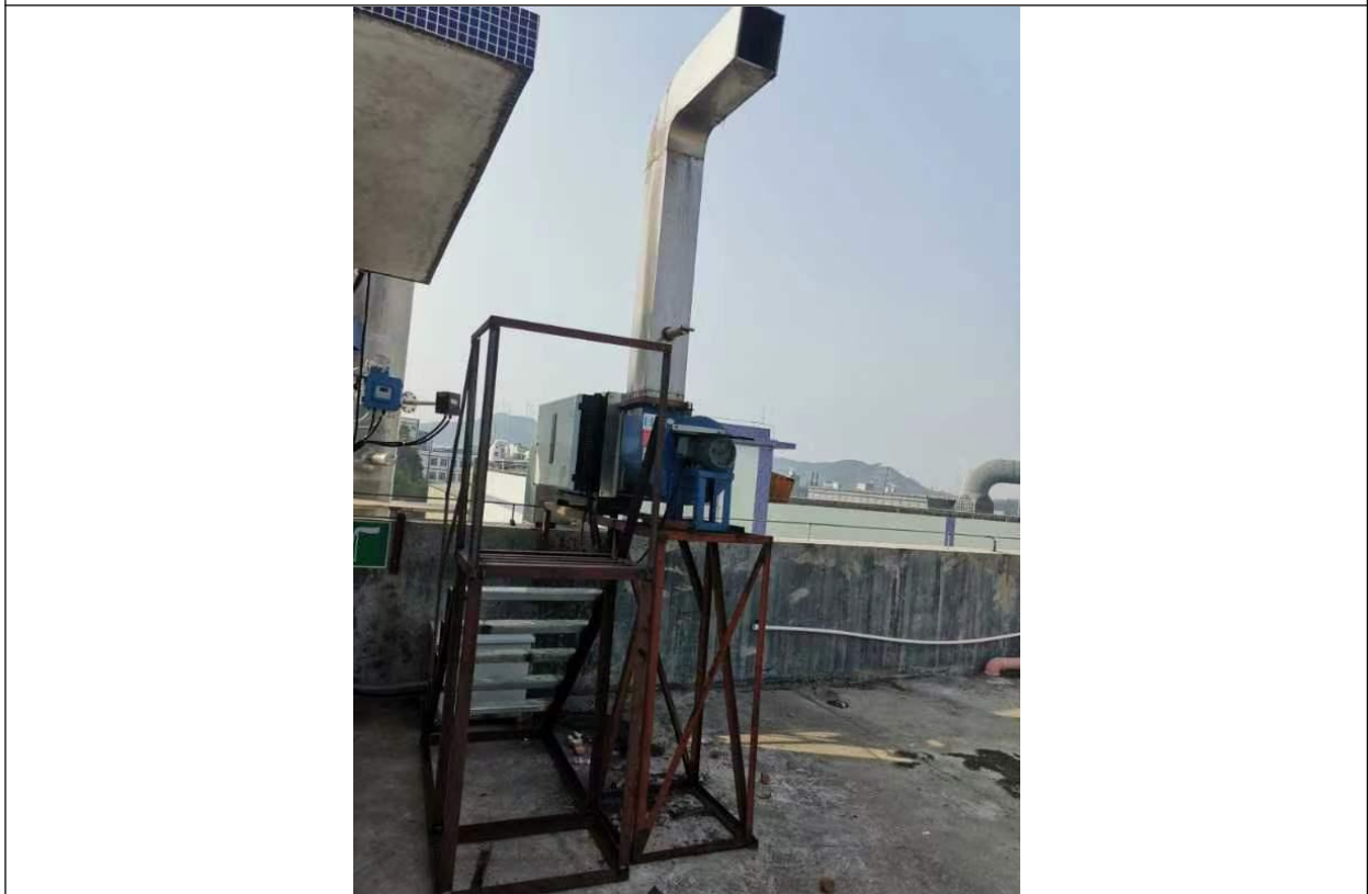
图 3 食堂油烟排放口 DA003
