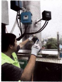
蒸汽发生器废气排放口 DA002
